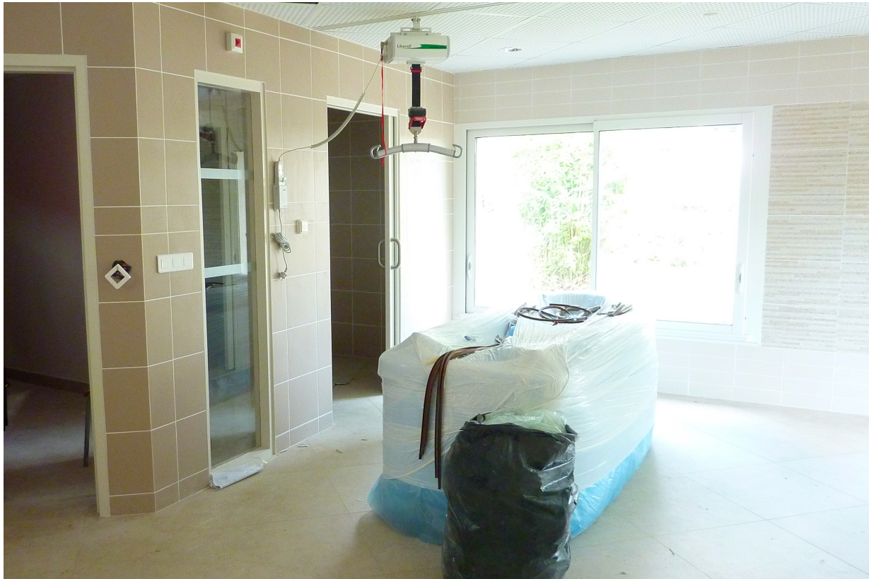
Figure 26 : UVP St Rémy - La salle de Balnéothérapie équipée d'un rail souleve-personne et de la baignoire
