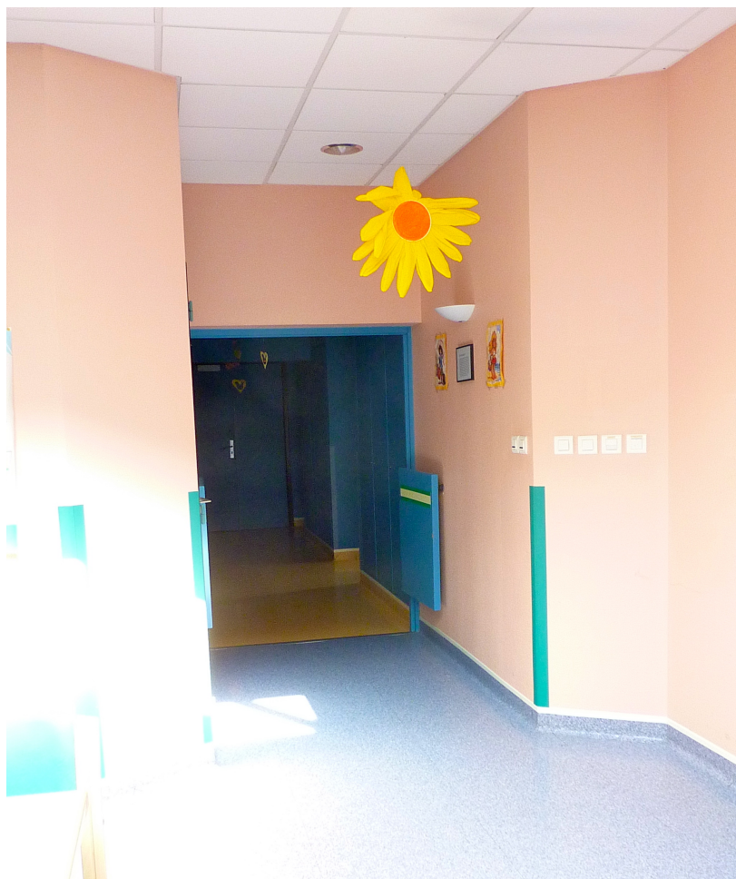
Figure 44 : UVP Ste Thérèse - Vue de la pièce de vie vers l'entrée de l'unité : l'obscurité dissuade les résidents de venir déambuler
