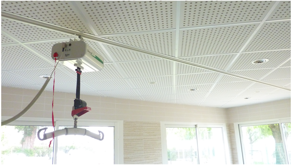
Figure 28 : UVP St Rémy - La salle de Balnéothérapie : le soulève-personne monté sur un rail intégré au plafond
