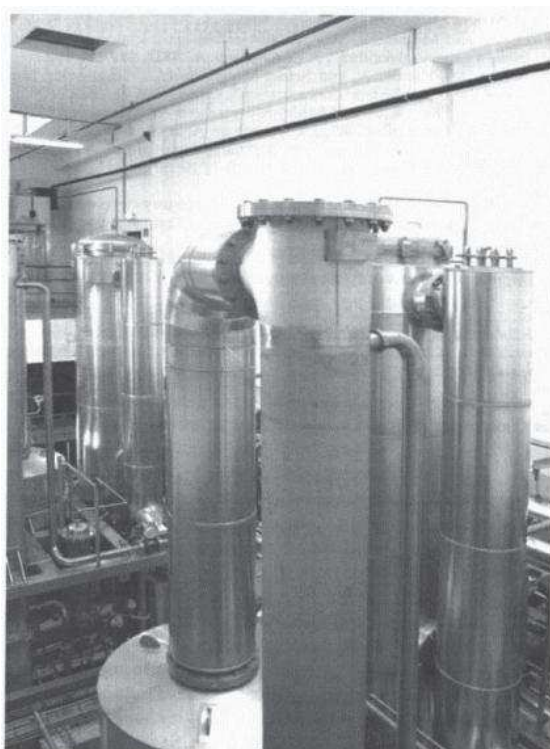
Figure 58 : Evaporateurs utilisés pour la récupération du solvant dans une chromatographie multicolonne continue « MCC 5-1000 » installée chez UCB Pharma (Braine, Belgique)
