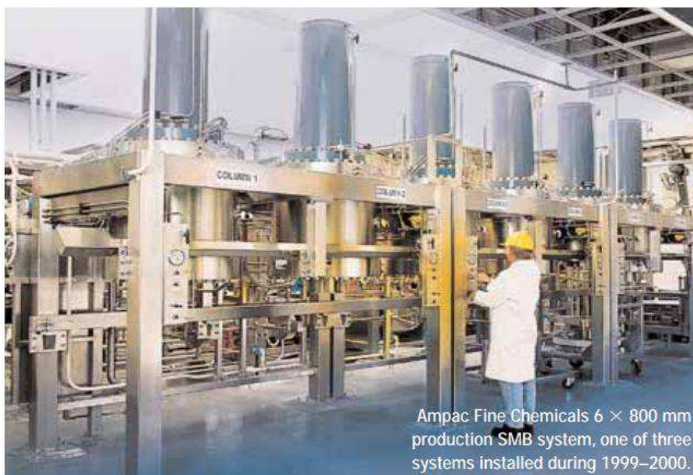
Figure 35 : Lit mobile simulé à 6 colonnes de 800 millimètres de diamètre
