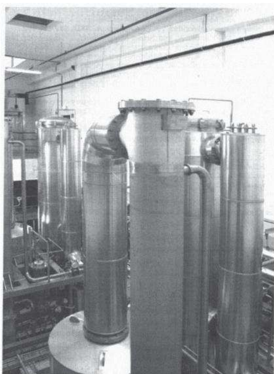
Figure 58 : Evaporateurs utilisés pour la récupération du solvant dans une chromatographie multicolonne continue « MCC 5-1000 » installée chez UCB Pharma (Braine, Belgique)
