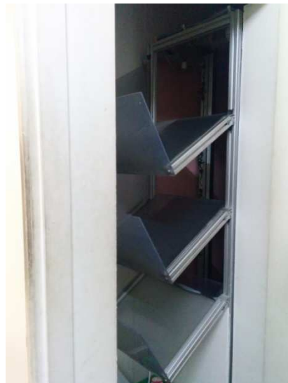
Figure 17 : Photo de l'ascenseur du Pharmax
