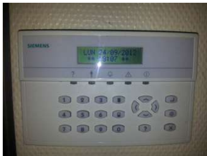
Figure 12 : Boîtier d'activation d'alarme
