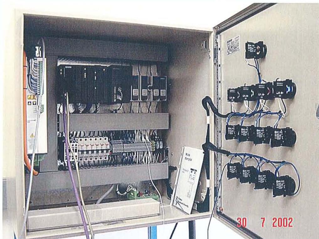
Intérieur de l'armoire électrique. L'automate est situé à l'extrême gauche.
