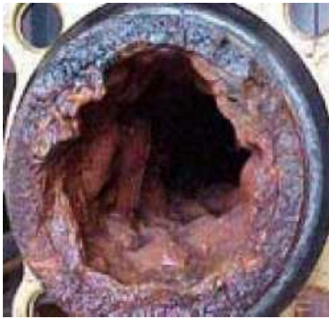
Figure 11 : Canalisation usée favorable à la formation de biofilms
