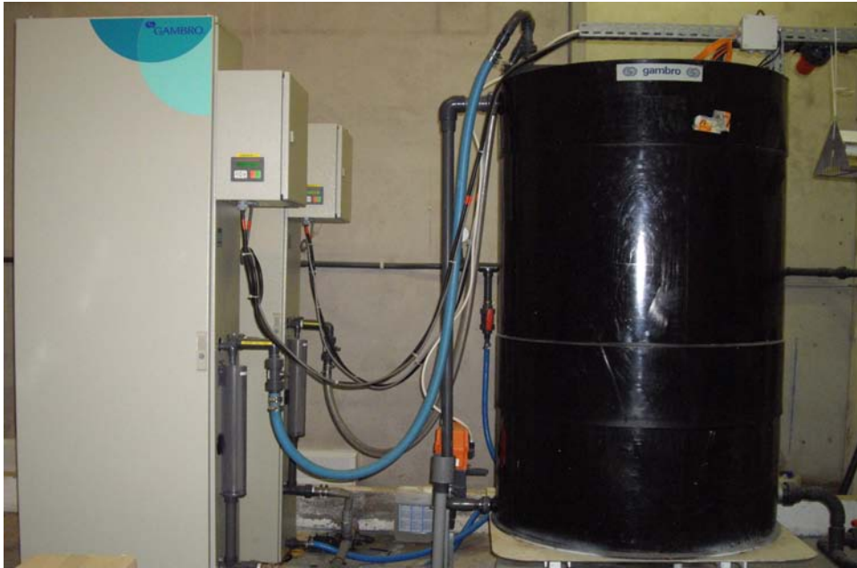
Figure 25 : Osmoseurs et cuve de stockage
