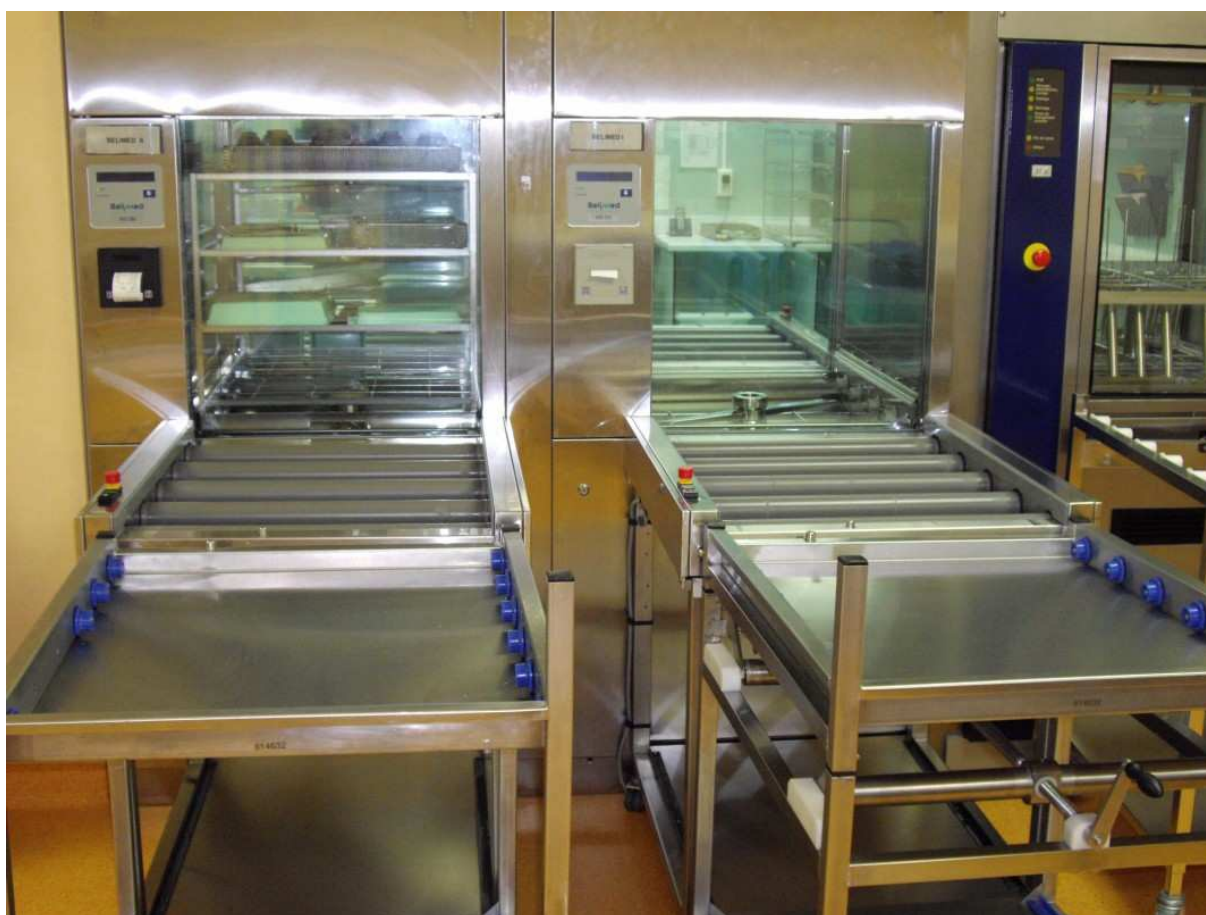
Figure 19 : Laveurs-désinfecteurs dont le chargement se fait en zone sale et le déchargement en zone propre
