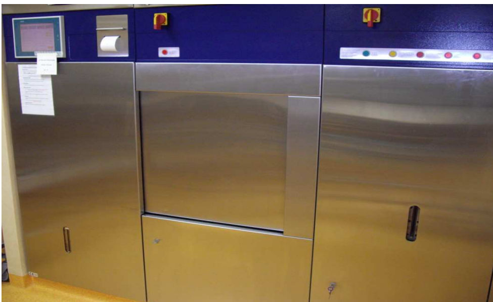
Figure 22 : Stérilisateurs Schaerer ASD8 en cours de fonctionnement
