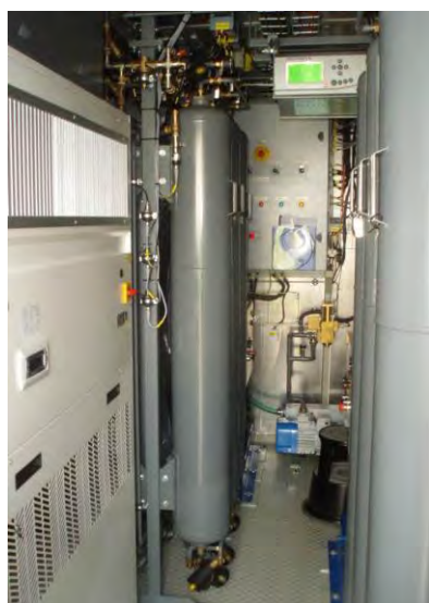
Figure 57 : 2 lignes de 3 colonnes PSA
