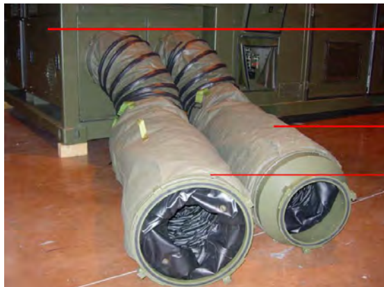
Figure 70 : gaines du climatiseur (43)
