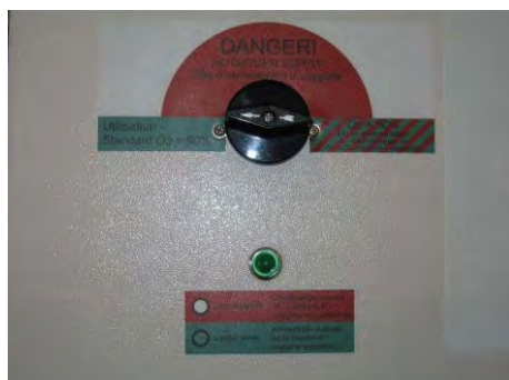
Figure 53 : commutateur mode de secours
