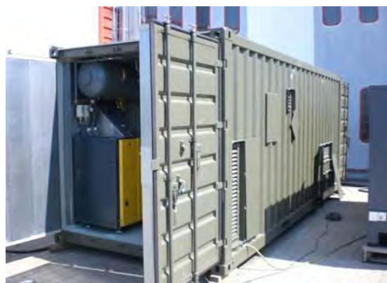
Figure 56 : vue externe du shelter du MPOGC
