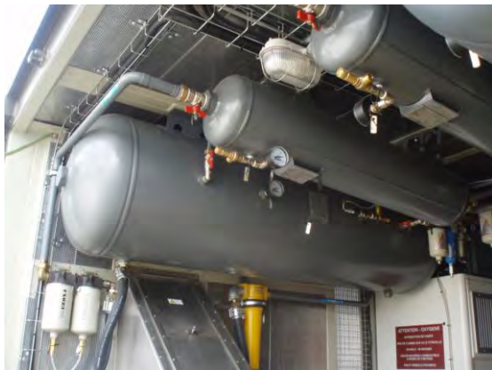
Figure 59 : système air : réservoir de 150L et filtre charbon
