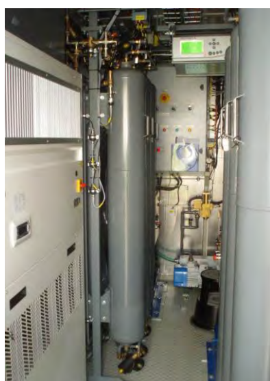
Figure 57 : 2 lignes de 3 colonnes PSA
