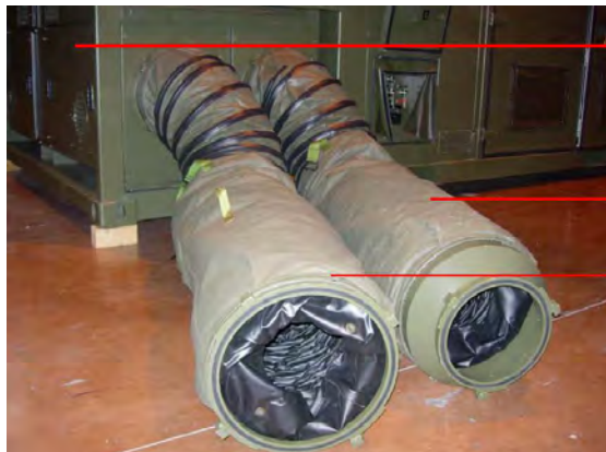
Figure 70 : gaines du climatiseur (43)
