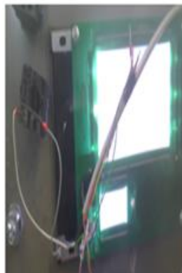
vue d'intérieure cablage consigne
