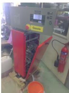
vue d'extérieure Cablage consigne
