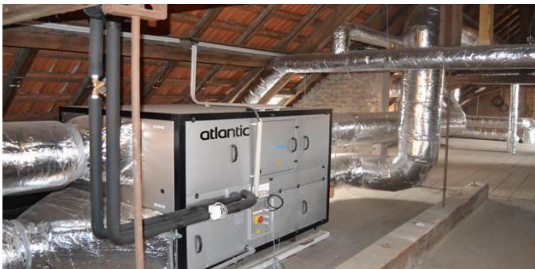
Figure 2 : Exemple de mise en œuvre d'une VMC DF DUOTECH 3300
