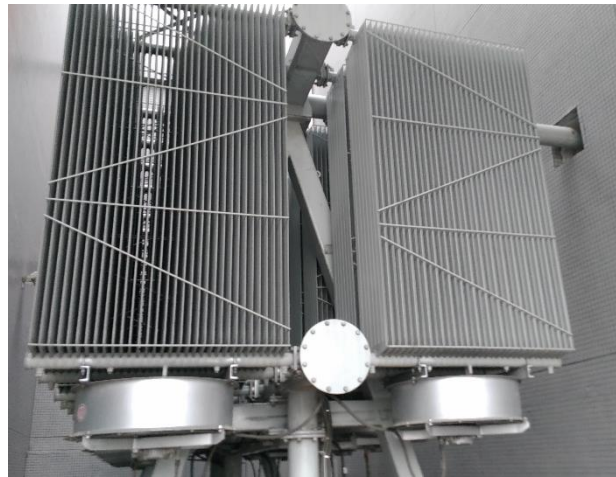
Ventilation du transformateur
