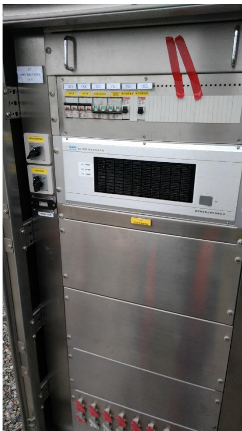
Terminal intelligent qui commande le disjoncteur
