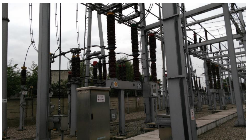
Le disjoncteur sur terrain
