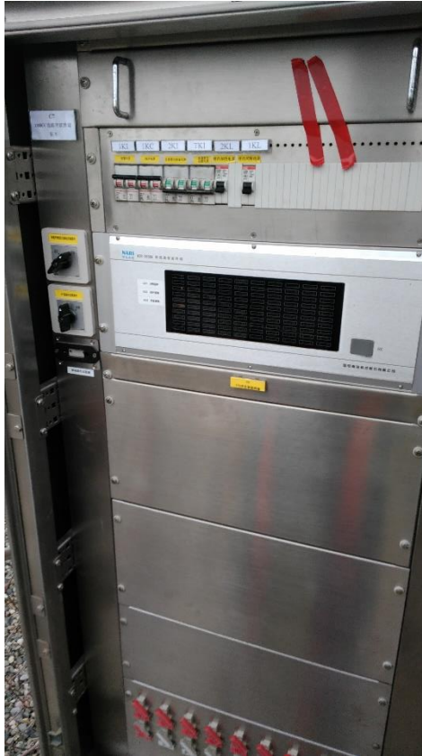
Terminal intelligent qui commande le disjoncteur
