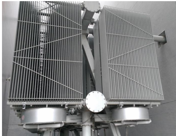
Ventilation du transformateur
