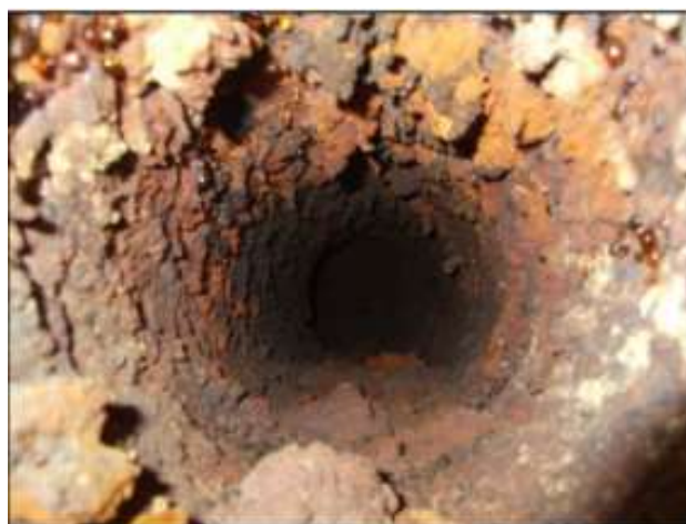
Figure 6 Etat de la canalisation de mise en distribution au droit de l'ancien réservoir
