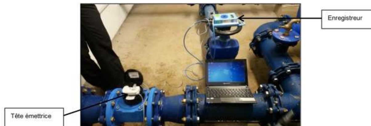
Figure 13 Installation de l'enregistreur sur le compteur de mise en distribution
