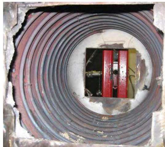
Figure 21 _ Intérieur du four
