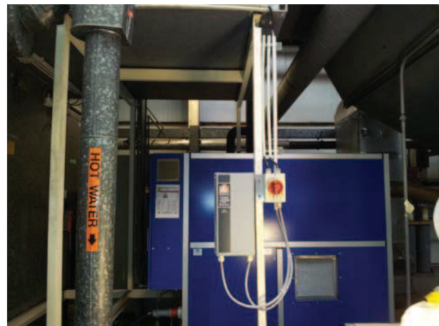
Variateur du moteur d'extraction
