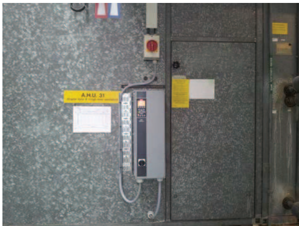
Variateur du moteur de pulsion
