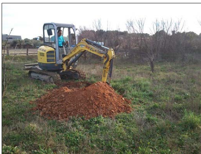
Figure 13 : Photographie d'une pelle mécanique lors d'une étude géologique pour une future zone d'activité
