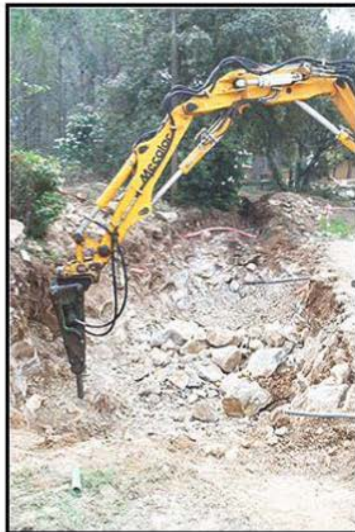
Terrassement en milieu rocheux pour la mise en place du filtre à sable - Utilisation d'un brise roche hydraulique
