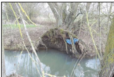
Dessouchement d'arbres (ici, l'arbre tombé dans le lit majeur n'est pas problématique pour l'écoulement)
