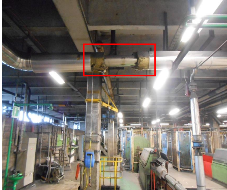
Photo d'une canalisation non calorifugé du circuit EC DMB
