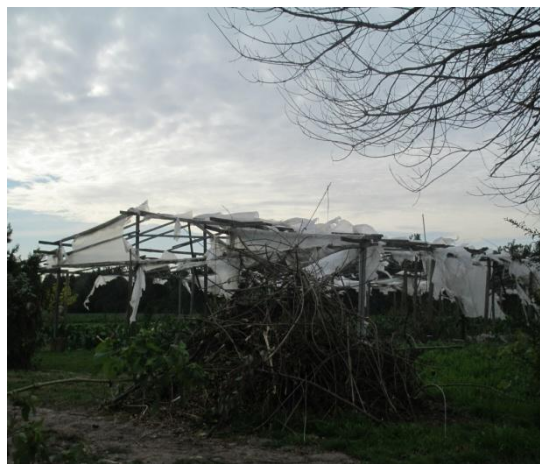
19.b Photographie 2 : Serre détruite par une tempête (P3)
