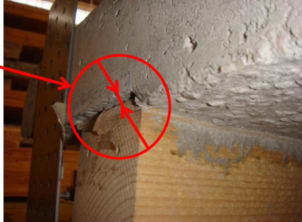
Photo 24 : Déplacement relatif à la rupture
