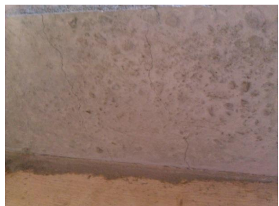
Photo 23 : Fissuration du béton
