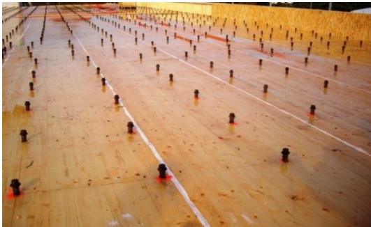
Photo 1 : Prédalle de bois munie de connecteurs avant pose du ferrailage et du béton
