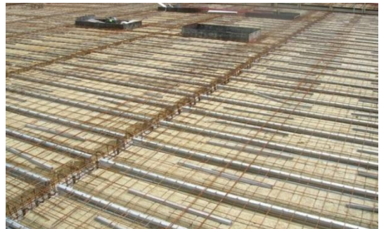
Photo 2 : Prédalle de bois munie de connecteurs avec ferrailage, bac acier et isolant
