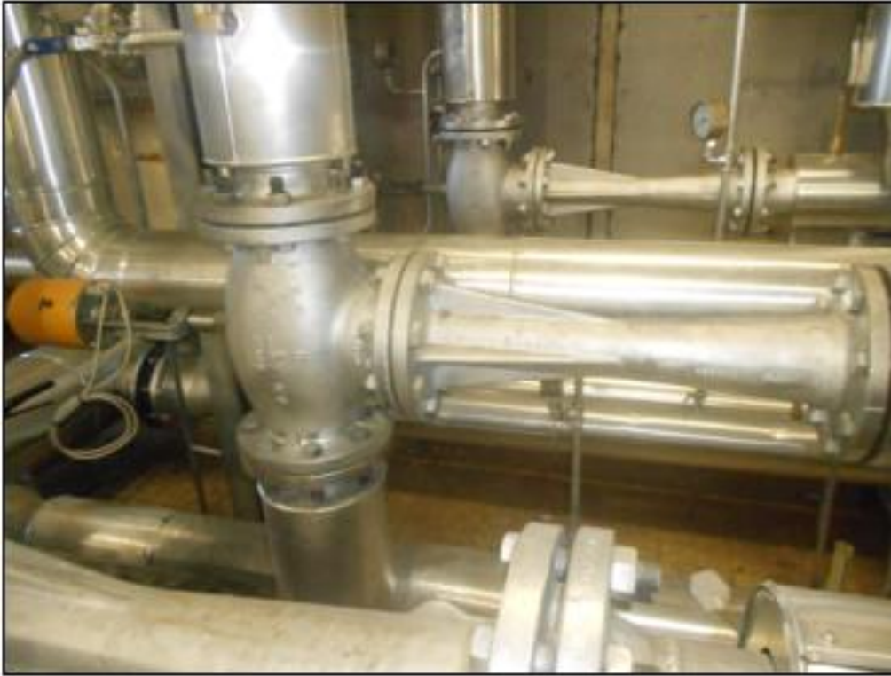
Figure 10 - Photographie des hydroéjecteurs de la sous-station Fac des Sciences
