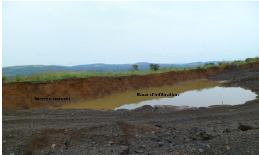
Figure 11 : Le bassin de rétention dans la zone B8 sud.
