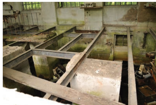
Intérieur de l'ancien poste gazométrique (sous-sol inondé)
