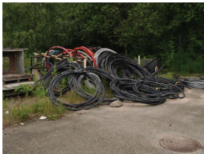
Stockage de câbles électriques
