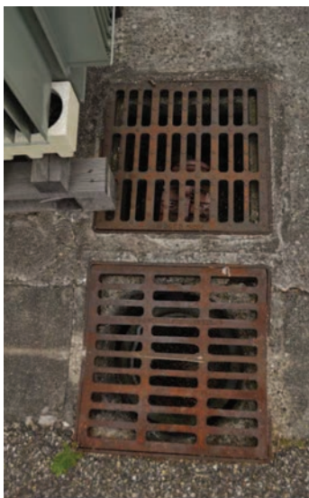
Bouches de récupération des eaux au niveau des transformateurs
