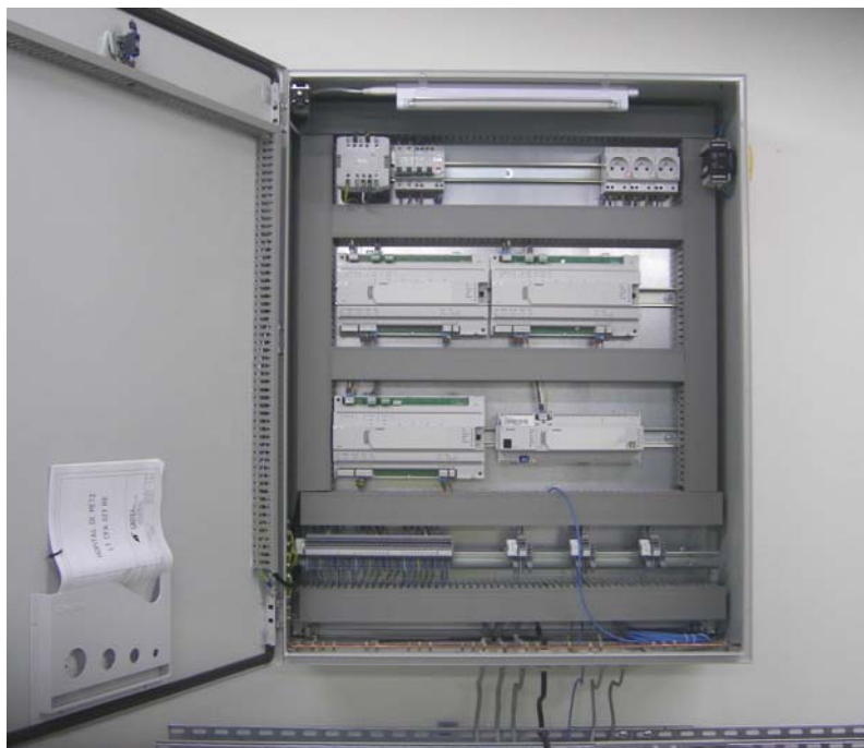
Figure 4 : Coffret de GTB
