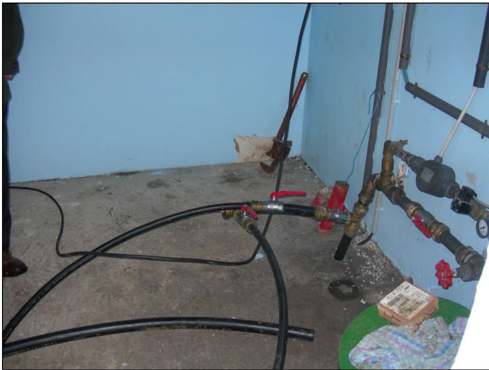
Photo c : By-pass permettant l'alimentation en eau du réservoir par le forage F
