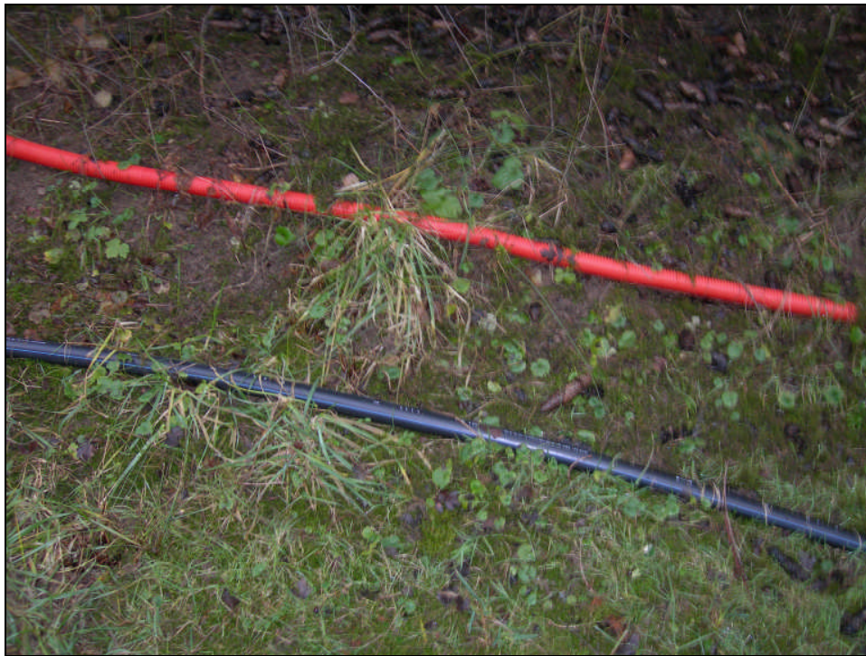
Photo b : Conduite d'adduction provisoire du forage F vers le local du forage P3
