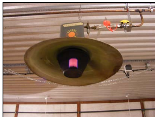
Photographie 3. Radiant de chauffage utilisé
