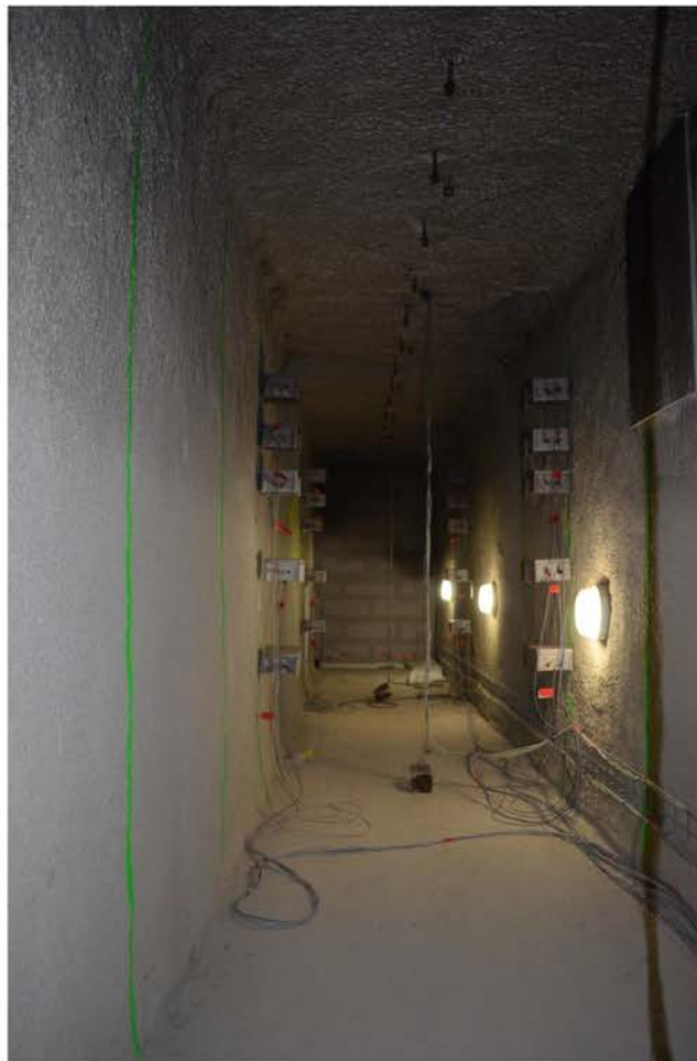
Fig. IV.3 — Photographie prise avant les essais dans la pièce-couloir : thermocouples et opacimètres
