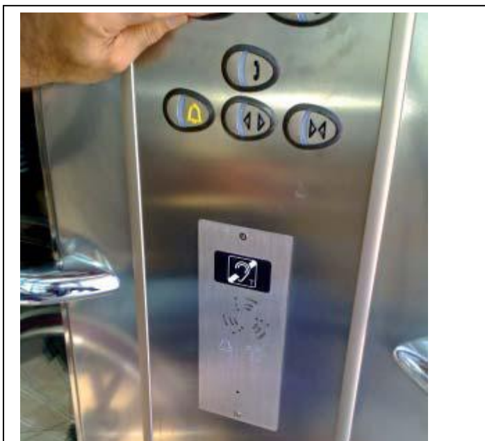
Figure 12 : Boucle d'induction magnétique dans un ascenseur. [25]
