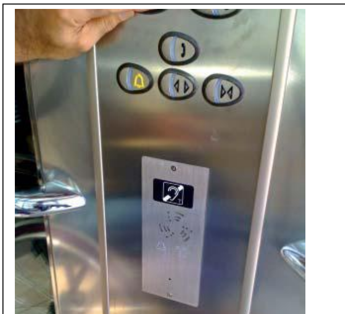
Figure 12 : Boucle d'induction magnétique dans un ascenseur. [25]
