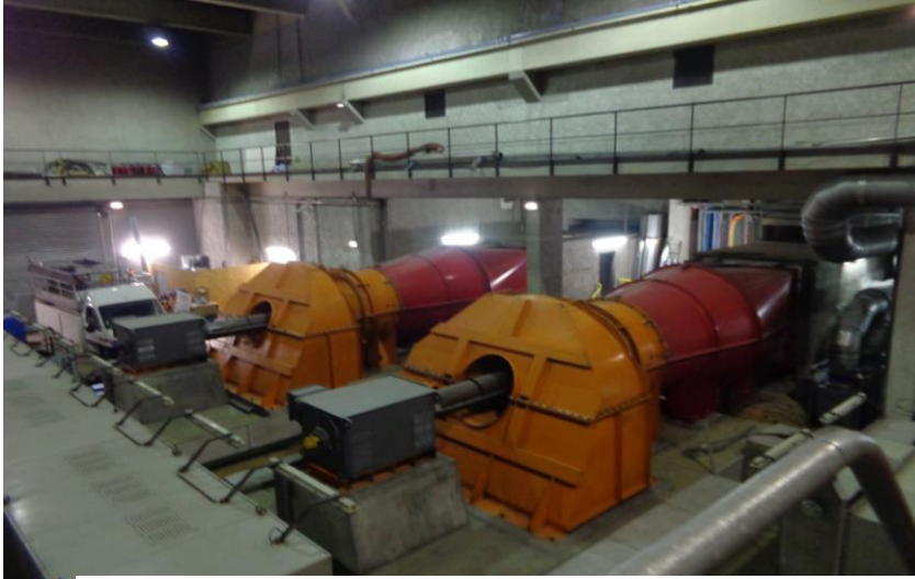
Figure 26 : Usine de ventilation localisée dans le tunnel du Fréjus
