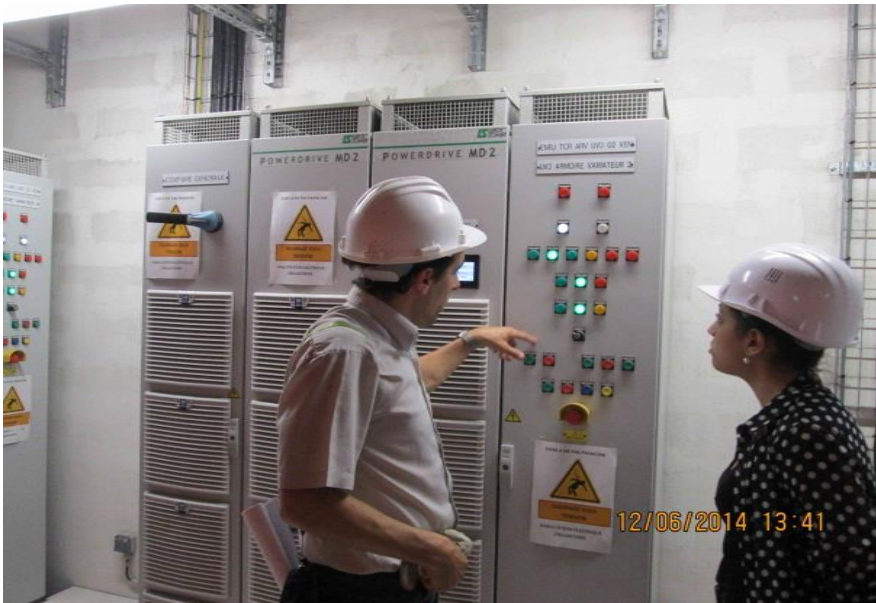
Figure 25 : Armoire de commande pour un ventilateur dans le tunnel de la Croix Rousse
