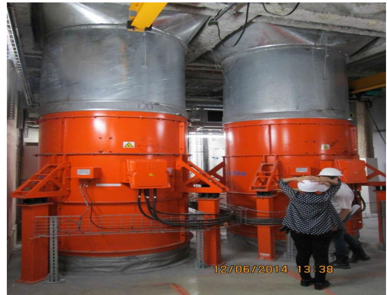
Figure 27 : Usine de ventilation dans le tunnel de la Croix Rousse
