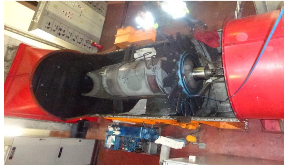
Figure 28 : Ventilateur ouvert pour la maintenance périodique au tunnel du Fréjus
