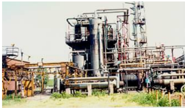
Figure 6: Photo du traitement Gaz - BENZOL
