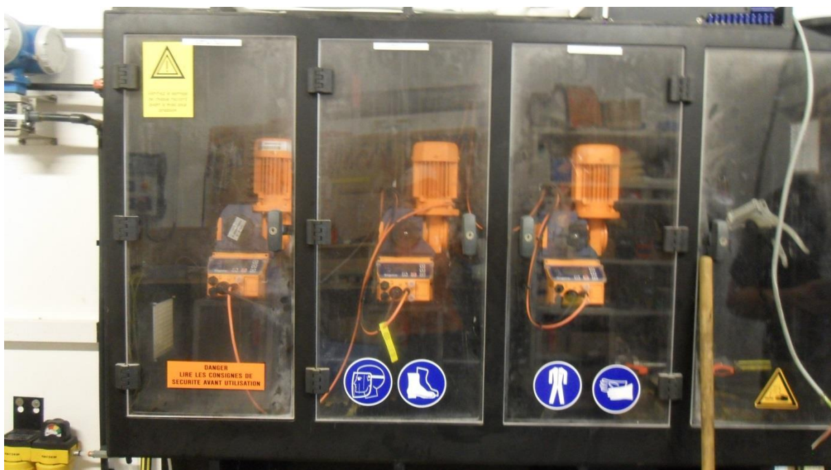
Photo 13: Coffret et pompes d'injection du chlorure ferrique.
