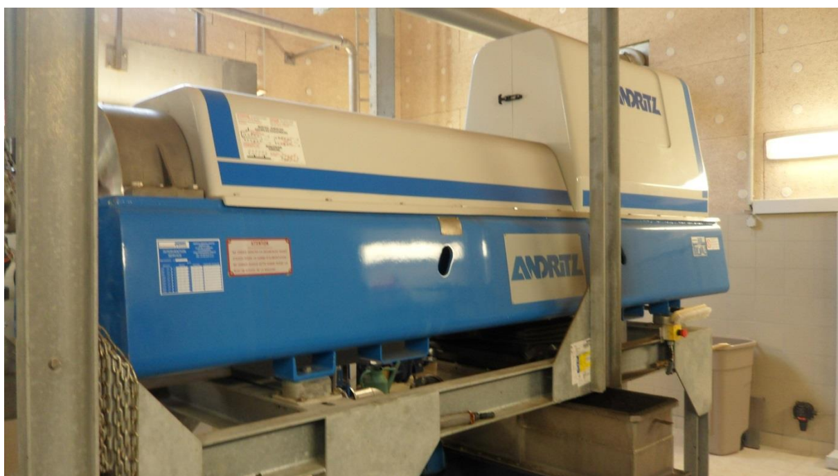
Photo 16: Centrifugeuse (déshydratation des boues).
