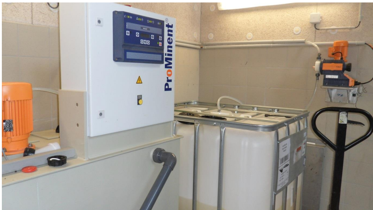
Photo 15: Cuve et préparation polymère pour la centrifugeuse.
