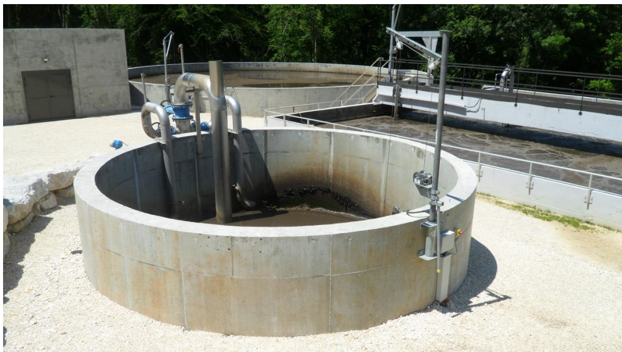
Photo 5: Zone de contact (zone tampon et répartition des effluents vers les BA).
