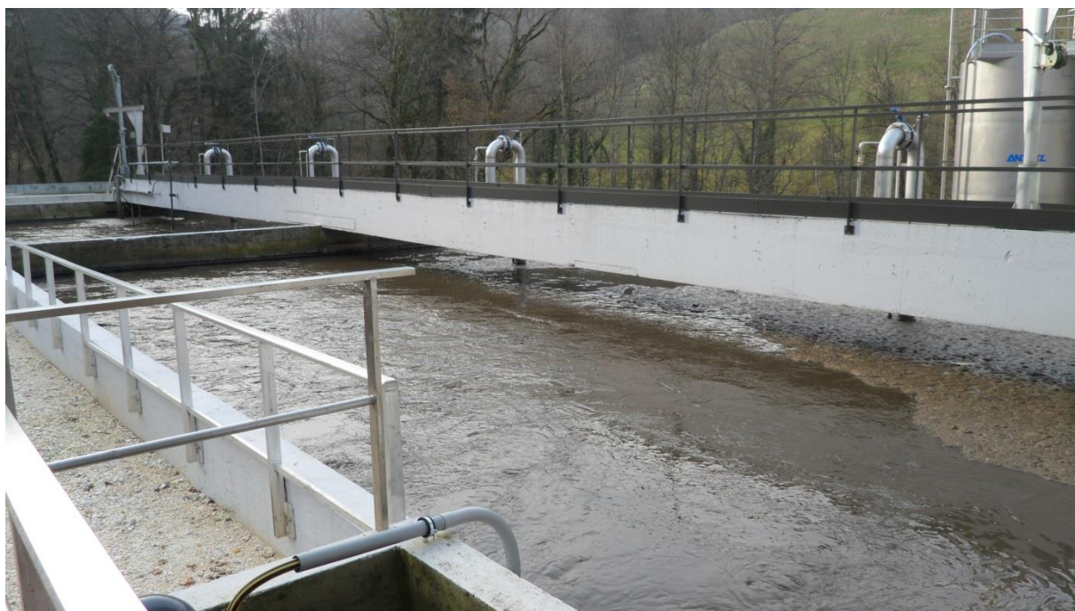
Photo 6: Bassin d'aération ancien (rectangulaire).
