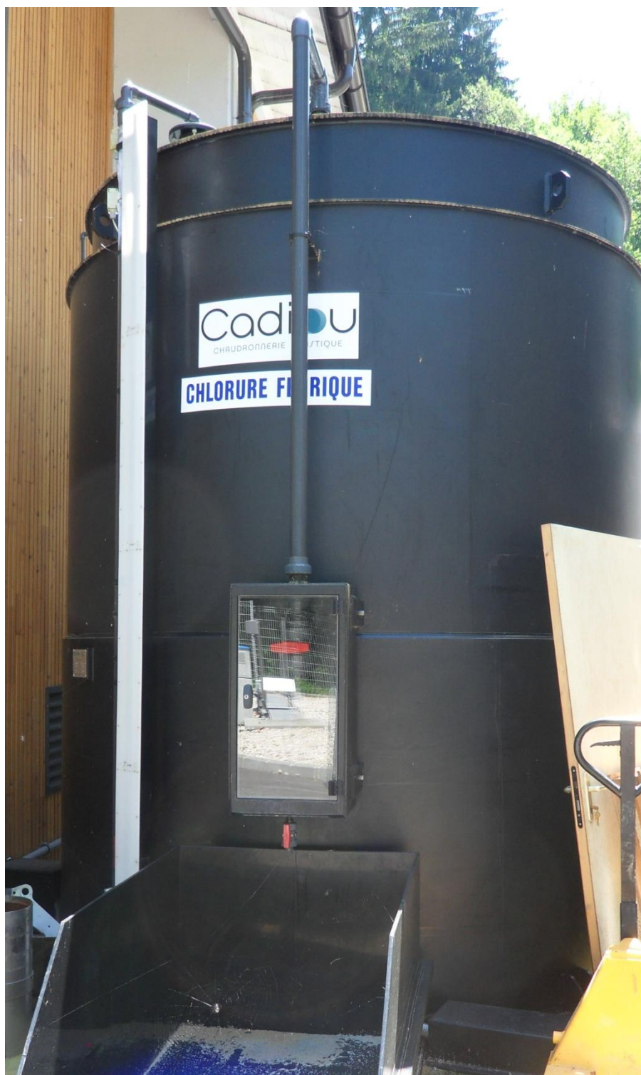
Photo 12: Cuve de stockage pour chlorure ferrique.
