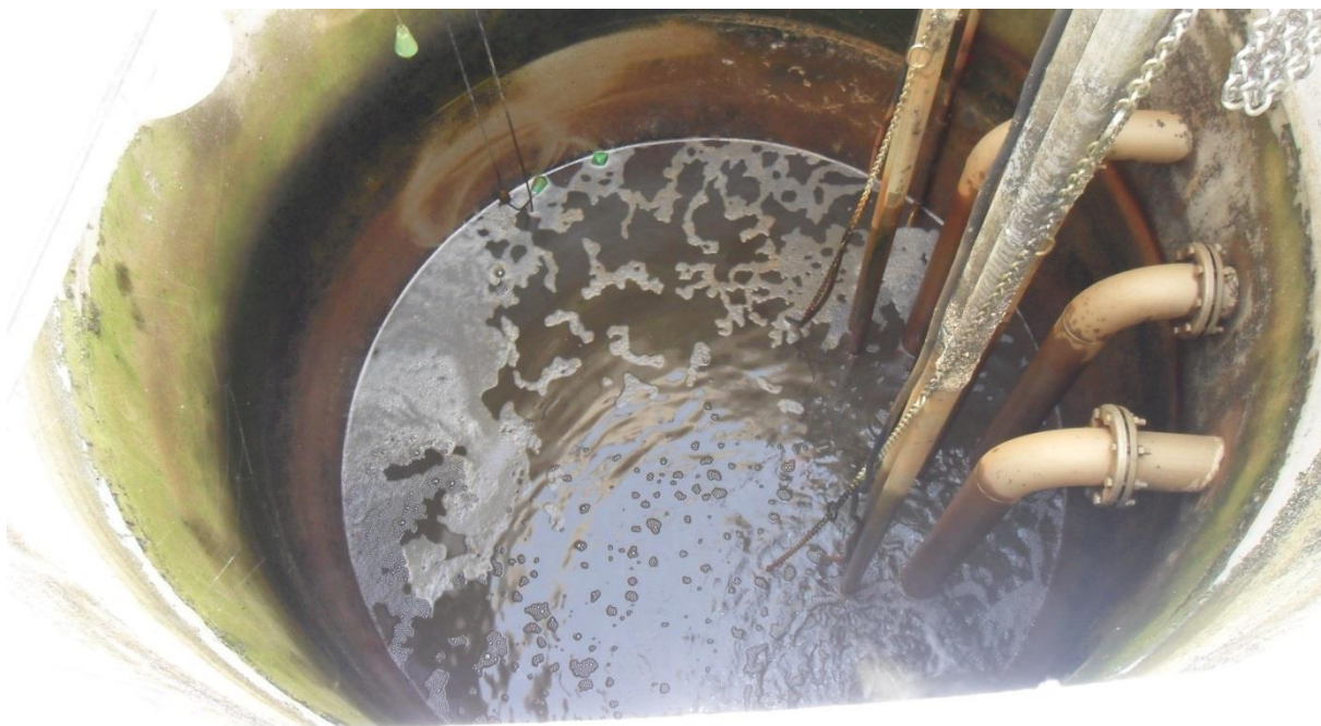
Photo 10: Poste de relèvement tertiaire.
