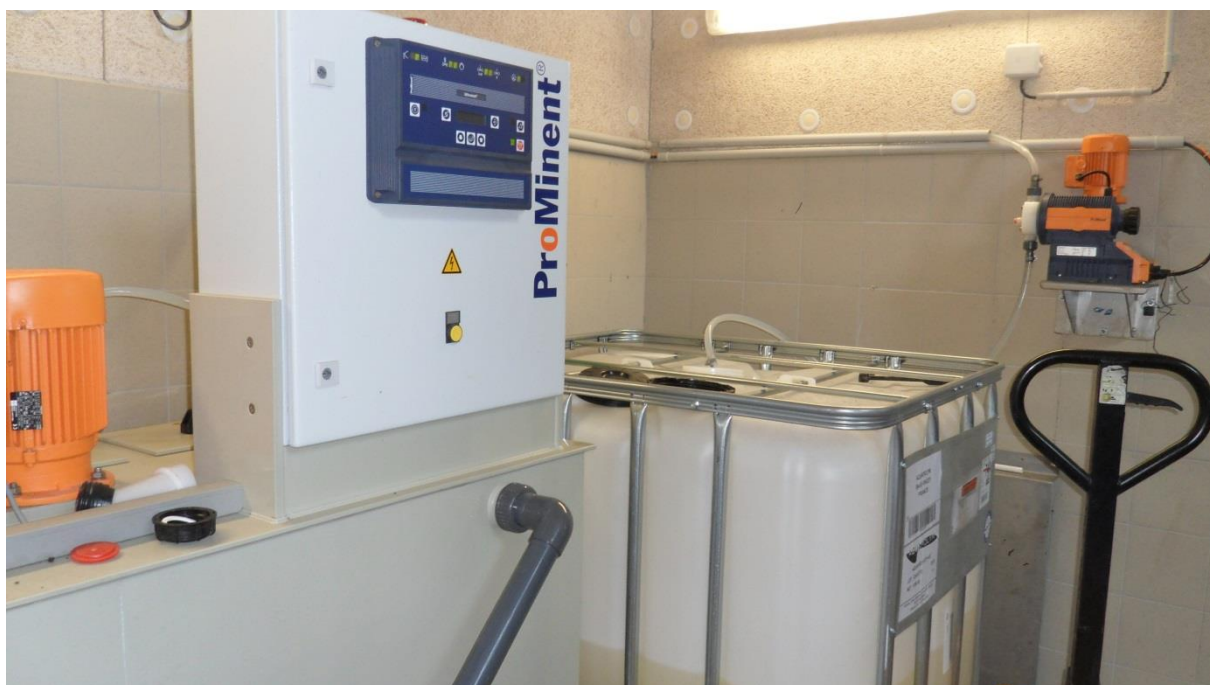
Photo 15: Cuve et préparation polymère pour la centrifugeuse.
