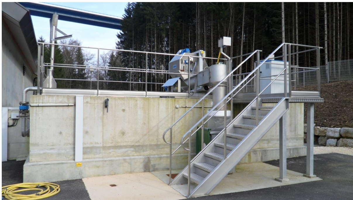
Photo 1: Ouvrage d'acquisition des eaux brutes.
