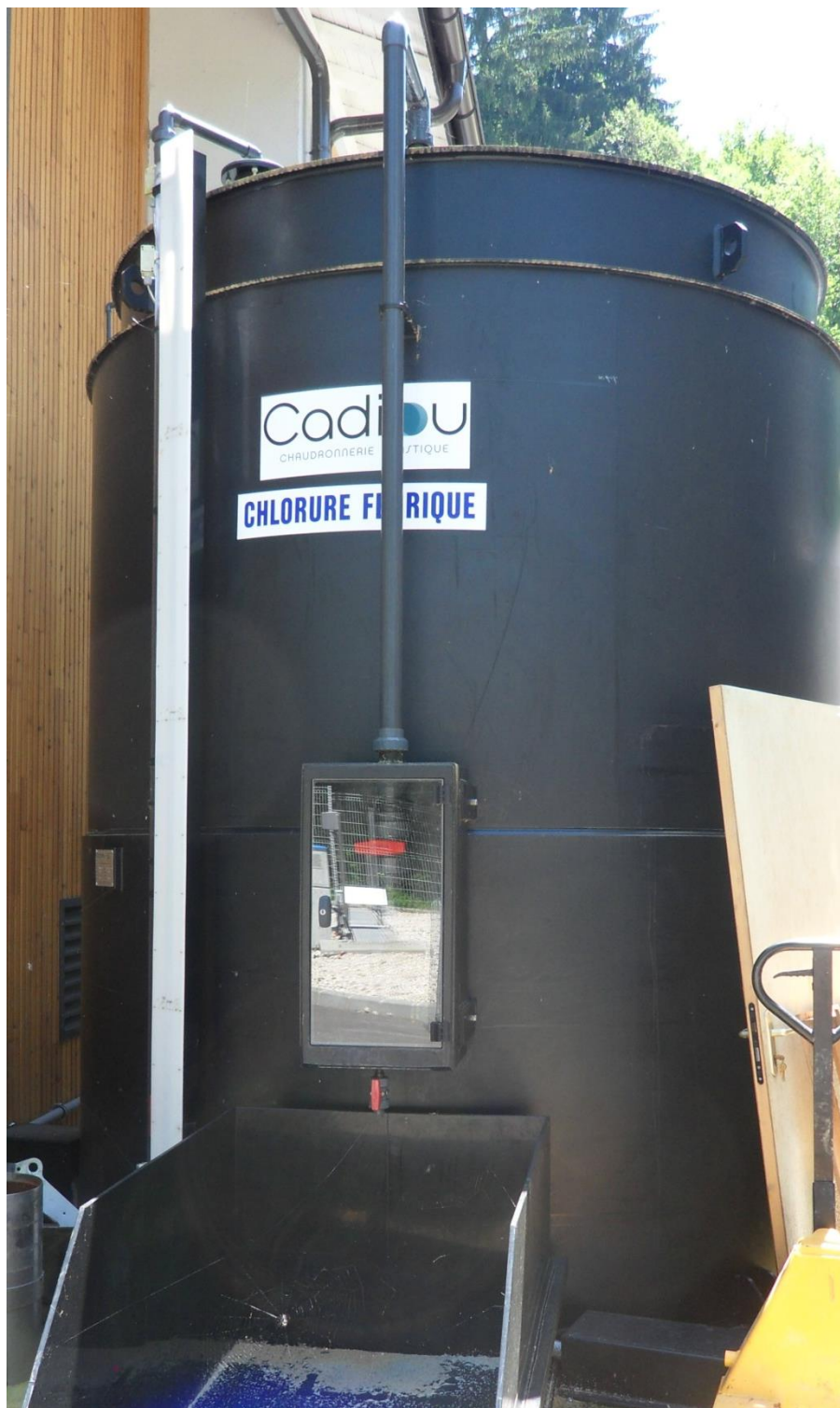
Photo 12: Cuve de stockage pour chlorure ferrique.
