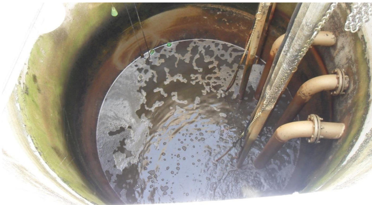
Photo 10: Poste de relèvement tertiaire.
