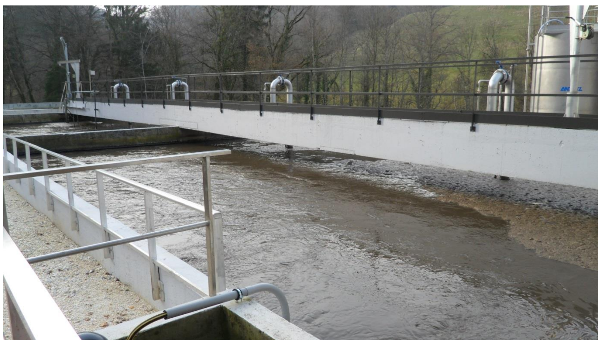
Photo 6: Bassin d'aération ancien (rectangulaire).
