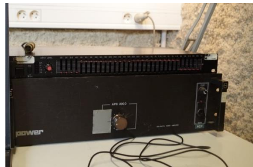
Figure 30 : Amplificateur branché en série entre le haut-parleur de diffusion et l'interface de branchement Net dB1
