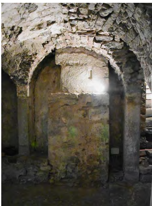
Fig.65 – Pilier séparant la nef du transept depuis la crypte. On remarque le négatif de l'enduit initial des voûtes (cliché © C. Moulis).
