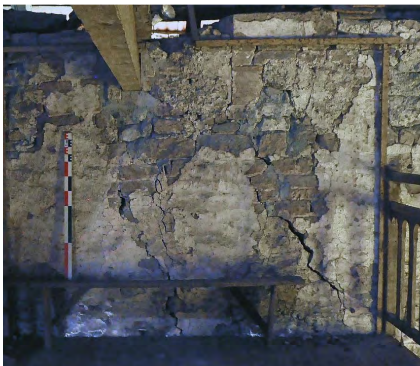
Fig.26 – Indice de fenêtre haute dans le mur gouttereau nord (cliché © C. Moulis).
