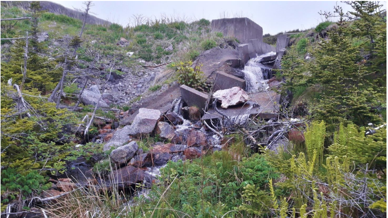
Annexe 44. Photo du tronçon S2 – Ruisseau Savoyard. La terminaison du canal est totalement détériorée, sous forme de débris, et perturbe considérablement le fonctionnement naturel du cours d'eau. Erwan Durand, 15/06/2021.
