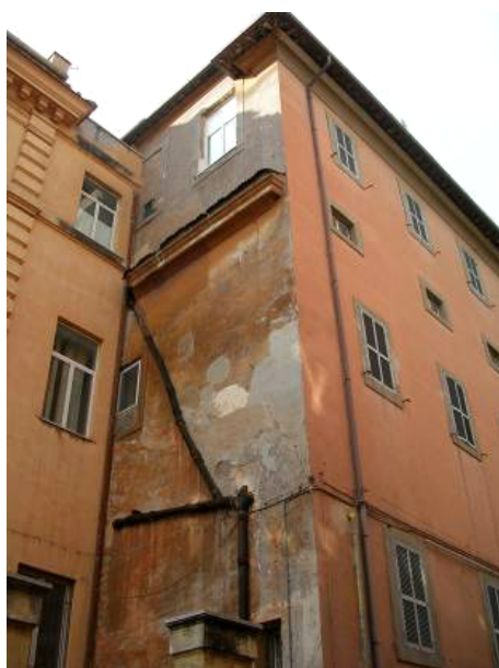
7. Rome, via Sforza, ancien monastère des annonciades célestes, angle sud, état actuel (cliché de l'autrice).
