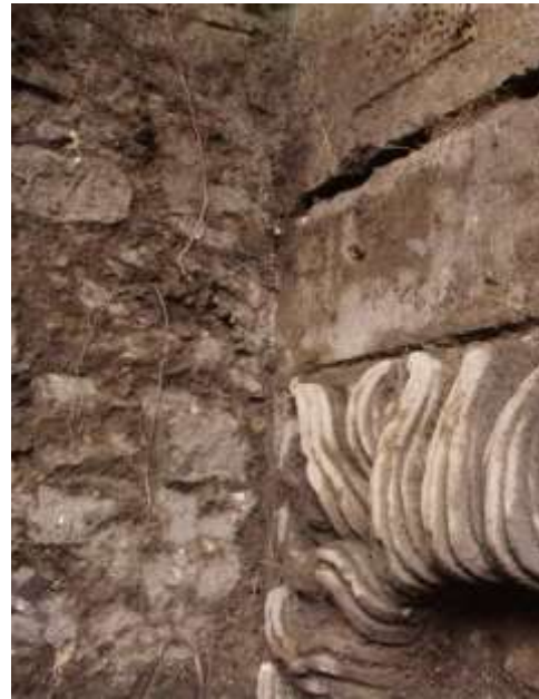
Figure 37 : La tour ne présente pas de chaînage avec le mur de fausse braie (cliché : J. Trapp)
