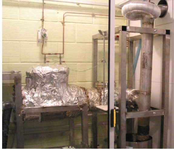
Figure 8 : Photographie du pilote calorifugé, vue d'ensemble sous la hotte.
