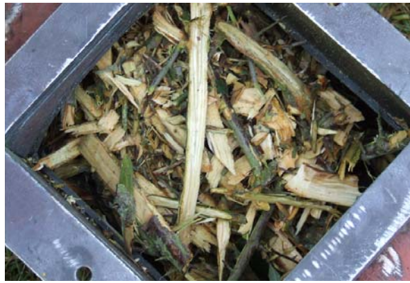
Figure 165 : Ouverture du coude d'évacuation après coupe et démontage, grande tige qui bloquent tout
