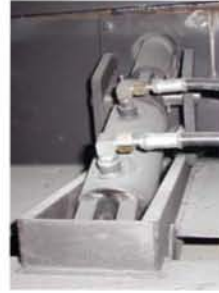
Figure 3-28 : Vue de l'ouverture occasionnant l'essentiel des fuites.
