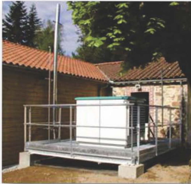
Figure 1.2 : Photographie de la pile à combustible de type PEMFC qui est située à Limoges dans le cadre du projet EPACOP. Ce programme vise à tester en conditions réelles d'utilisation cinq piles à combustibles dans quatre villes (Dunkerque, Nancy, Limoges et Sofia-Antipolis). D'une puissance de 5 kW en électricité et 7 kW en chaleur, elles alimentent des bâtiments administratifs. Cette expérimentation a débuté en 2003 pour une durée de deux ans.
